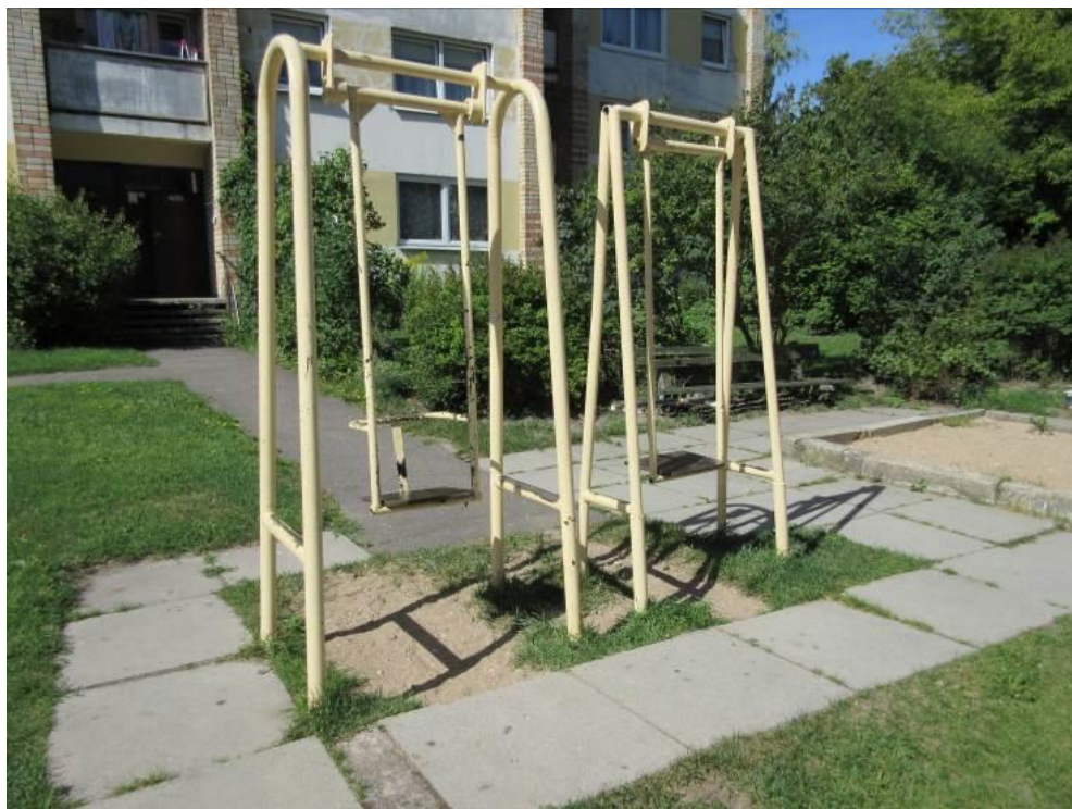
5.att. Šūpoles ar neatbilstībām
